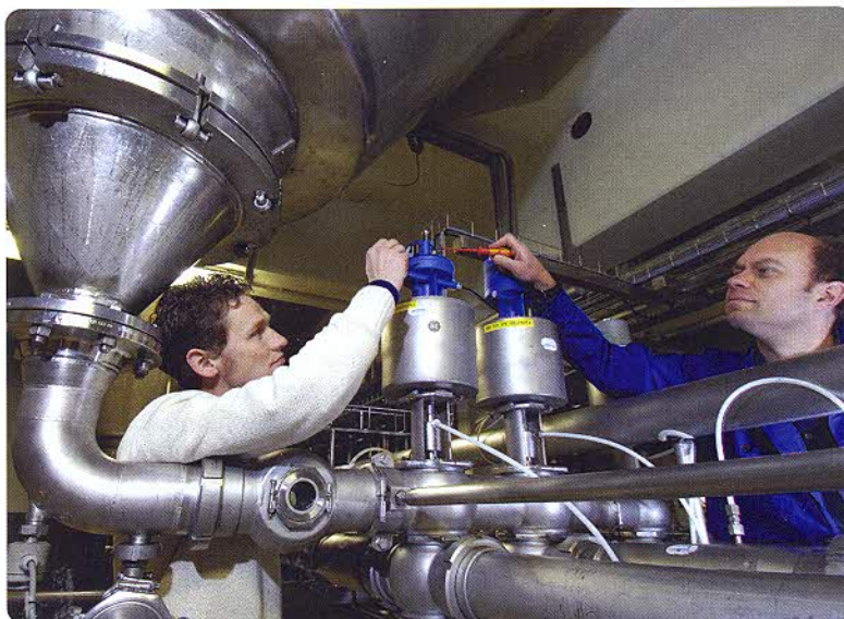
Bild 3: Im Rahmen der Modernisierungsarbeiten im Gär- und Lagerkeller wurde die gesamte Feldebene neu verdrahtet und Ventile mit Pilot-Köpfen nachgerüstet.
